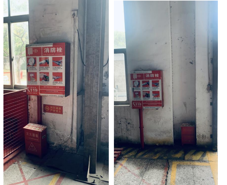
厂区内消防设施
